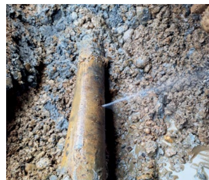
Dank den Geräuschloggern der Firma Hawle konnten drei Rohrdefekte festgestellt und rechtzeitig behoben werden.
