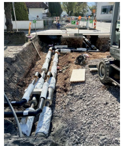
Blick in den offenen Leitungsgraben im Bereich Kirchstraße/Bahnhofstraße: In diesen isolierten Leitungen fließt zukünftig die Nahwärme in Form von Warmwasser direkt zu den angeschlossenen Haushalten und Betrieben.
