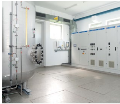
Druckwindkessel (links), Steuerungsanlage (rechts)
