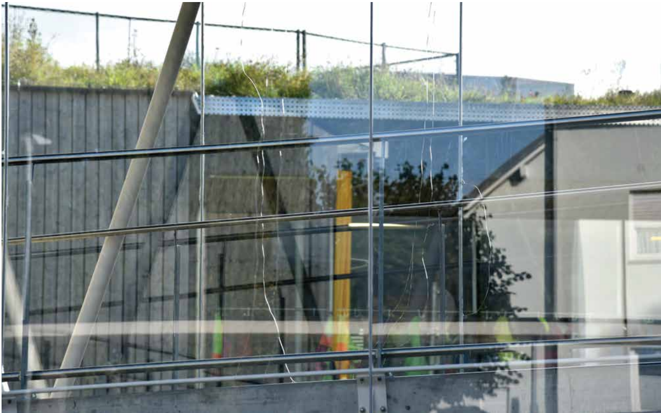
Immer wieder müssen mutwillig zerbrochene Scheiben an der Schule Dorf ersetzt werden
