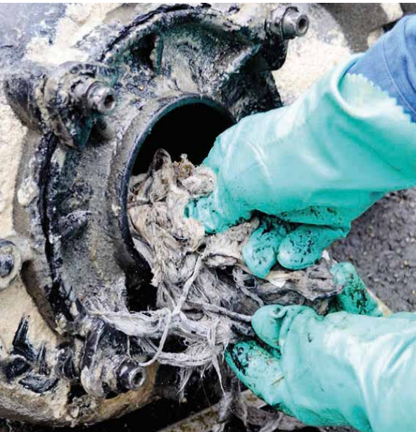
Feststoffe wie z.B. Feuchttücher, Tampons, Wattestäbchen verstopfen die Abwasserpumpen
