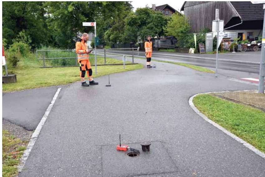
Die betroffene Stelle wird mittels GPS Gerät eingemessen und digital dokumentiert
