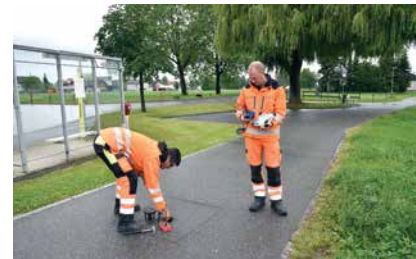
Bei entsprechendem Geräusch wird die genaue Lage des Rohrbruches mittels eines „Koordilators“ (genaue Lage) festgestellt
