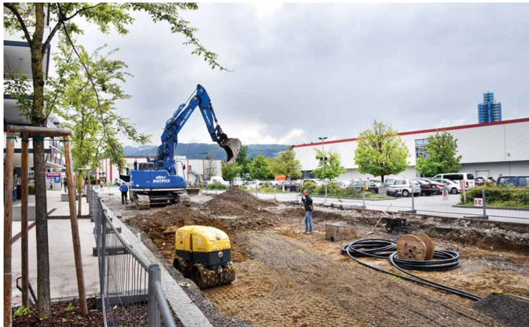
Die Kanalarbeiten und die Verlegung der Leitungen werden bis Ende Juni abgeschlossen sein
