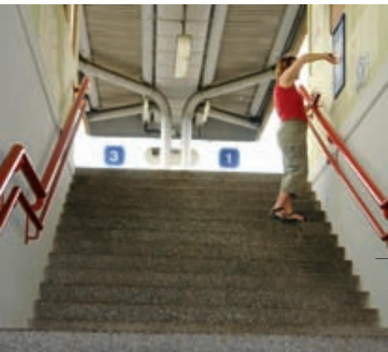
Für viele ein Hindernis: Die steilen Stufen zum Bahnsteig
