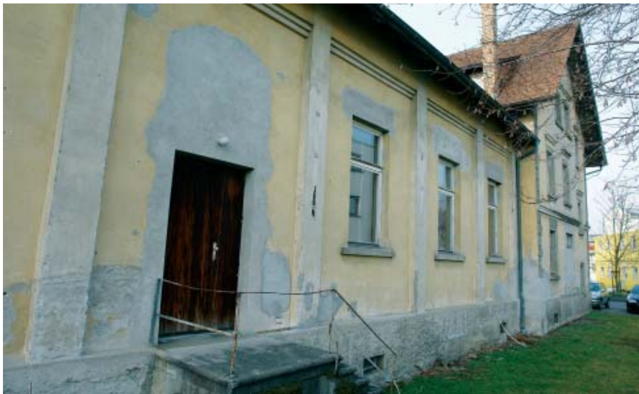
Das Alte Vereinshaus verfällt zusehends. Das traditionelle Gebäude soll in letzter Minute gerettet werden.
